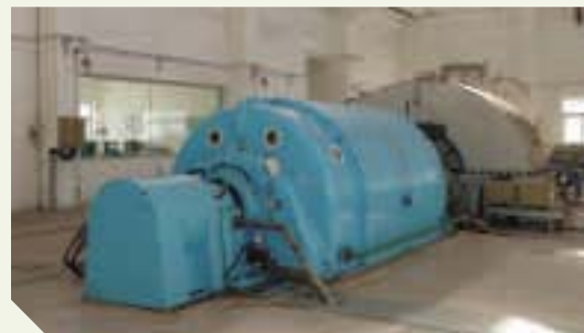
▲ 鞍钢烧结余热发电机组
